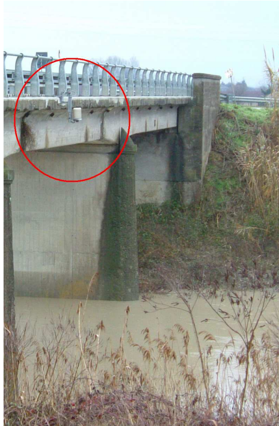
Figura 1- Esempio di teleidrometro posizionato sull'impalcato di un ponte, Montone a Ponte Braldo
